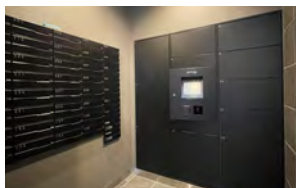
宅配ボックス
