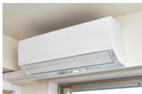
冷暖房エアコン
