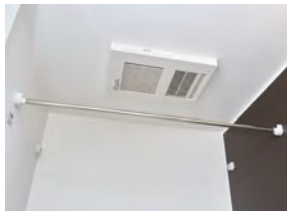
ランドリーパイプ
