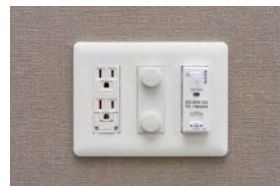
マルチメディアコンセント
